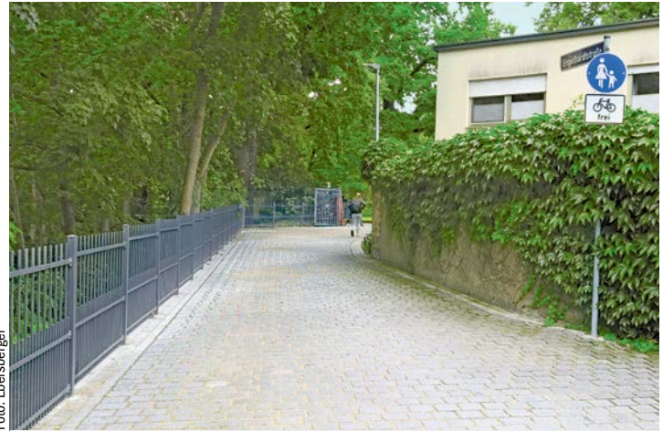
Ein dekorativer Metallzaun, eine neue Pflasterung und dazu eine neu errichtete Stützwand an der Böschungsseite: Die Engelhardtstraße wurde saniert und bildet nun das schicke Eingangstor zum Stadtpark.
